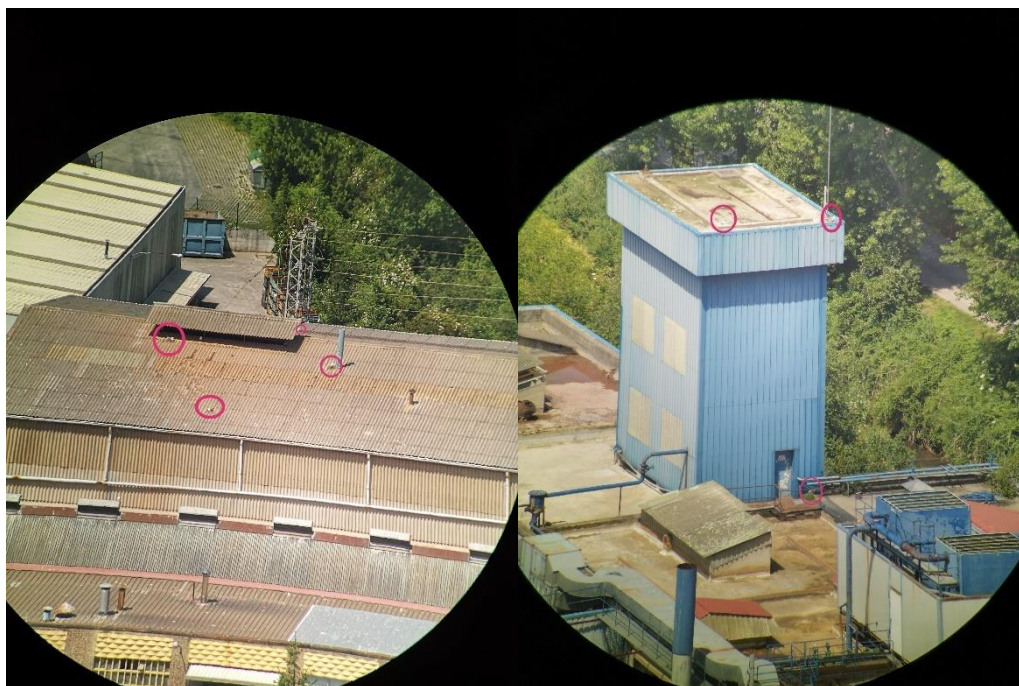
Seguimiento de nidos en emplazamientos sin garantía de seguridad o inaccesibles en naves industriales.
