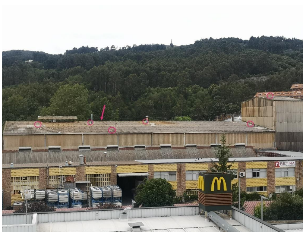
Posición de nidos no intervenidos por riesgo en nave industrial.
